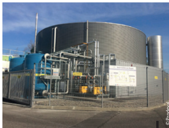
EXEMPLE DE RÉALISATION POUR UNE STATION D'ÉPURATION À VILLEURBANNE.
